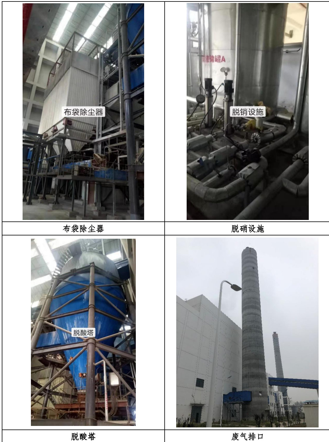
图 4.1-4 废气处理设施及排放口
